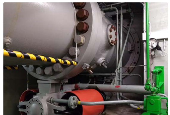
Einlauf im Kraftwerk Hopflauenen
